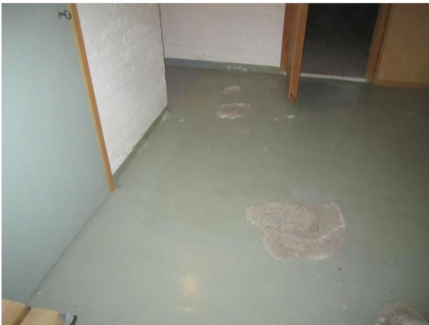
Kuva 6. Alapohja eli kellarin lattia on märkä
