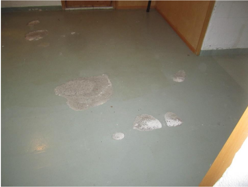
Kuva 5. Alapohja eli kellarin lattia on märkä
