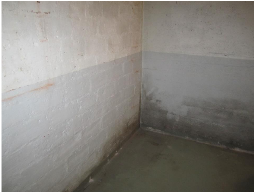
Kuva 1. Kellarin seiniin nousee maasta kosteutta.
