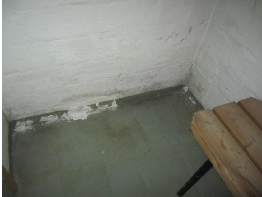
Kuva 2. Kellarin seinien alapäissä on kosteutta.
